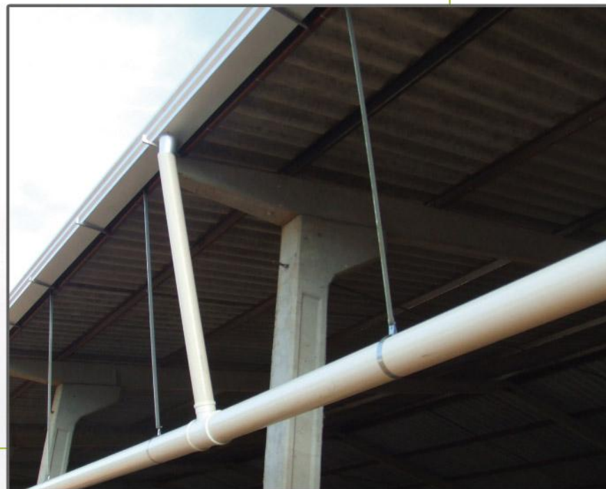
Calhas e Condutores
