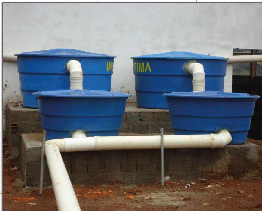
Sistemas de Filtragem
